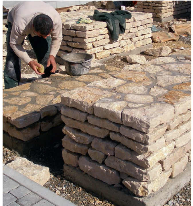
Jede einzelne Natursteinplatte wurde behauen und der Mörtel nach dem Ausfugen fein säuberlich abgewaschen.
