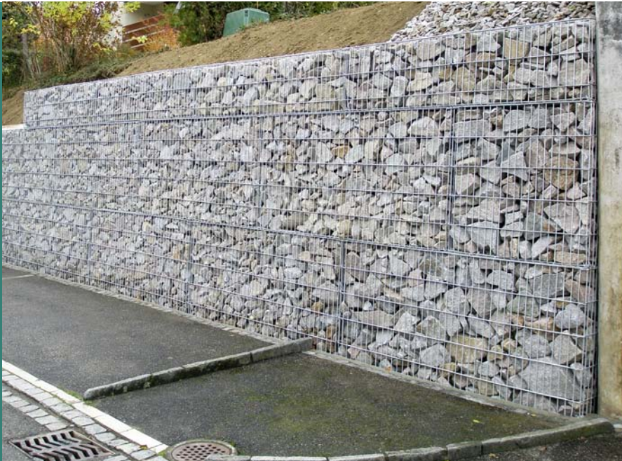
An der Betonwand am rechten Bildrand lässt sich der 5%-Anzug der abgetreppten Mauer erkennen.
