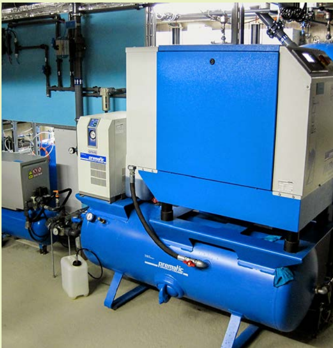
Der Luftdruckkompressor regelt mit den Steuerventilen das Wasserspiel an der Oberfläche.
