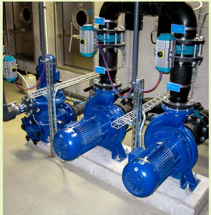
Die richtige Pumpe lässt sich erst nach einer genauen Beurteilung aller Kräfte und Widerstände ermitteln.
